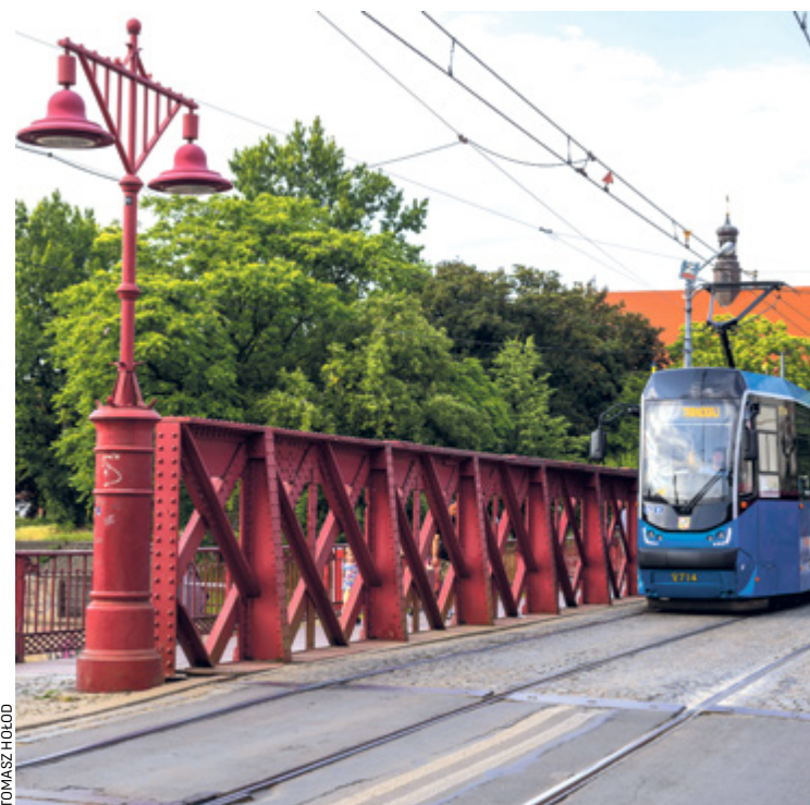
Most Piaskowy wymaga napraw jeszcze przed remontem generalnym
